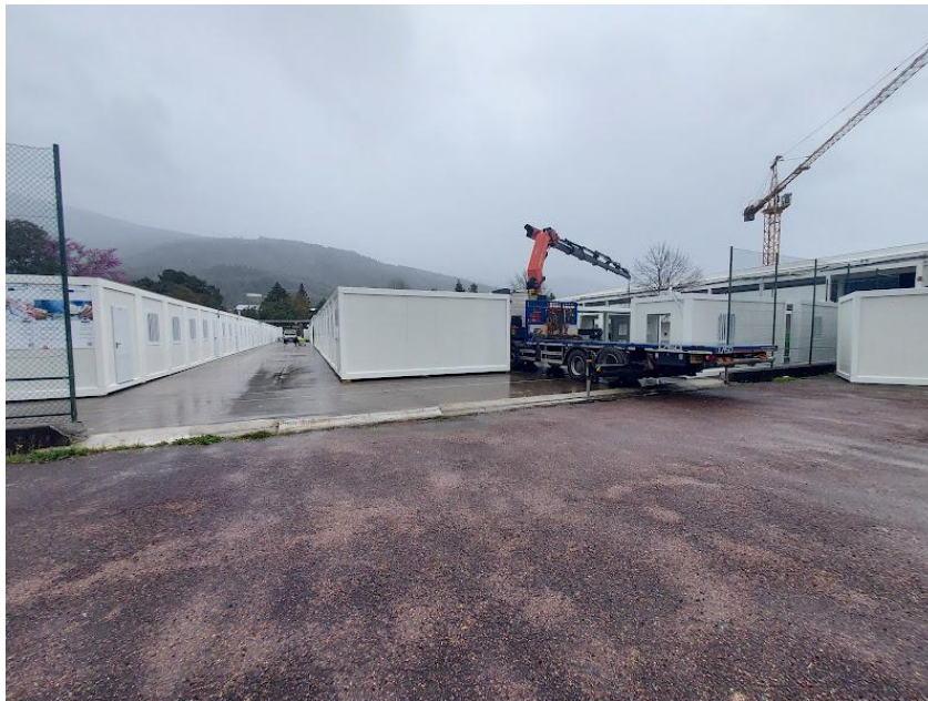
Figura 17 – Instalação de módulos para salas nas obras de requalificação da Escola Secundária
